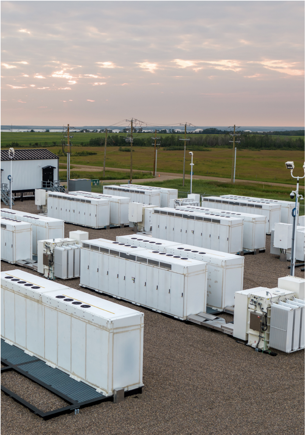
Almacenamiento de baterías de iones de litio.
