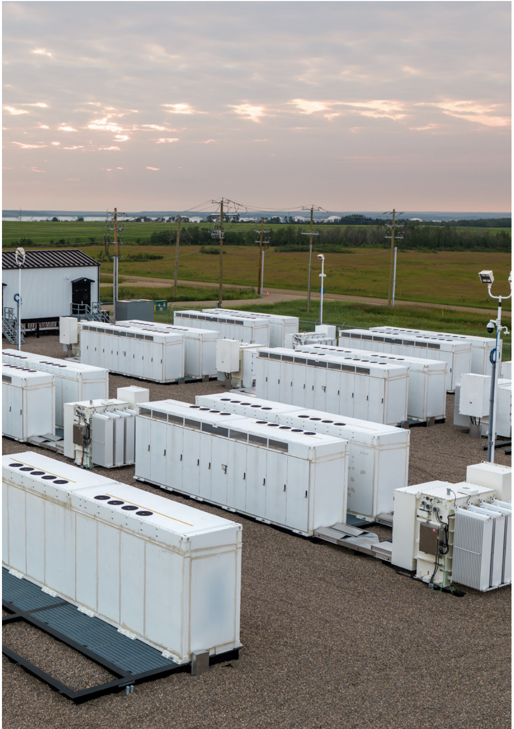
Almacenamiento de baterías de iones de litio.
