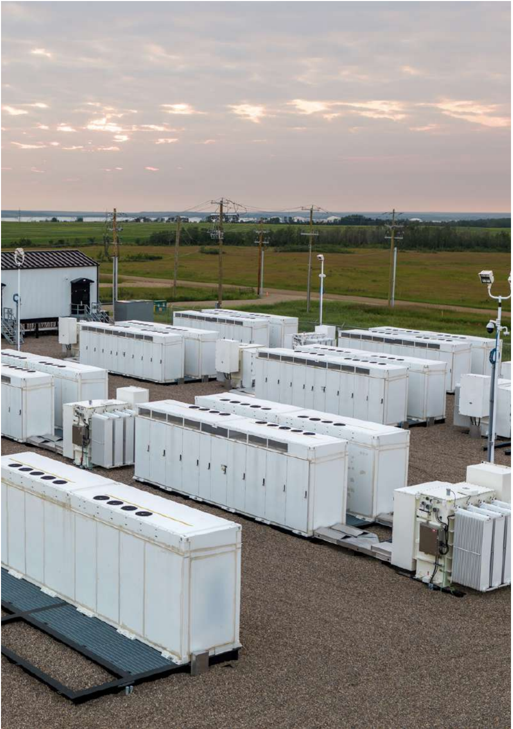
Almacenamiento de baterías de iones de litio.
